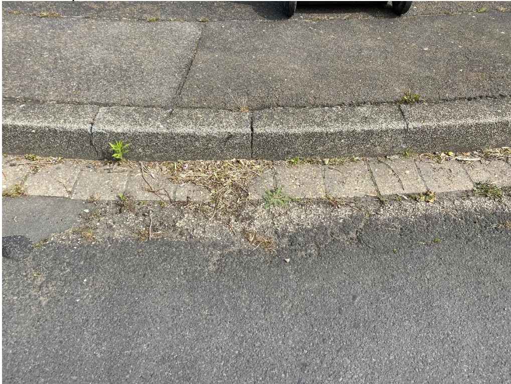
Bild 3: Neuer Ausbruch angrenzend an Reparaturstelle
