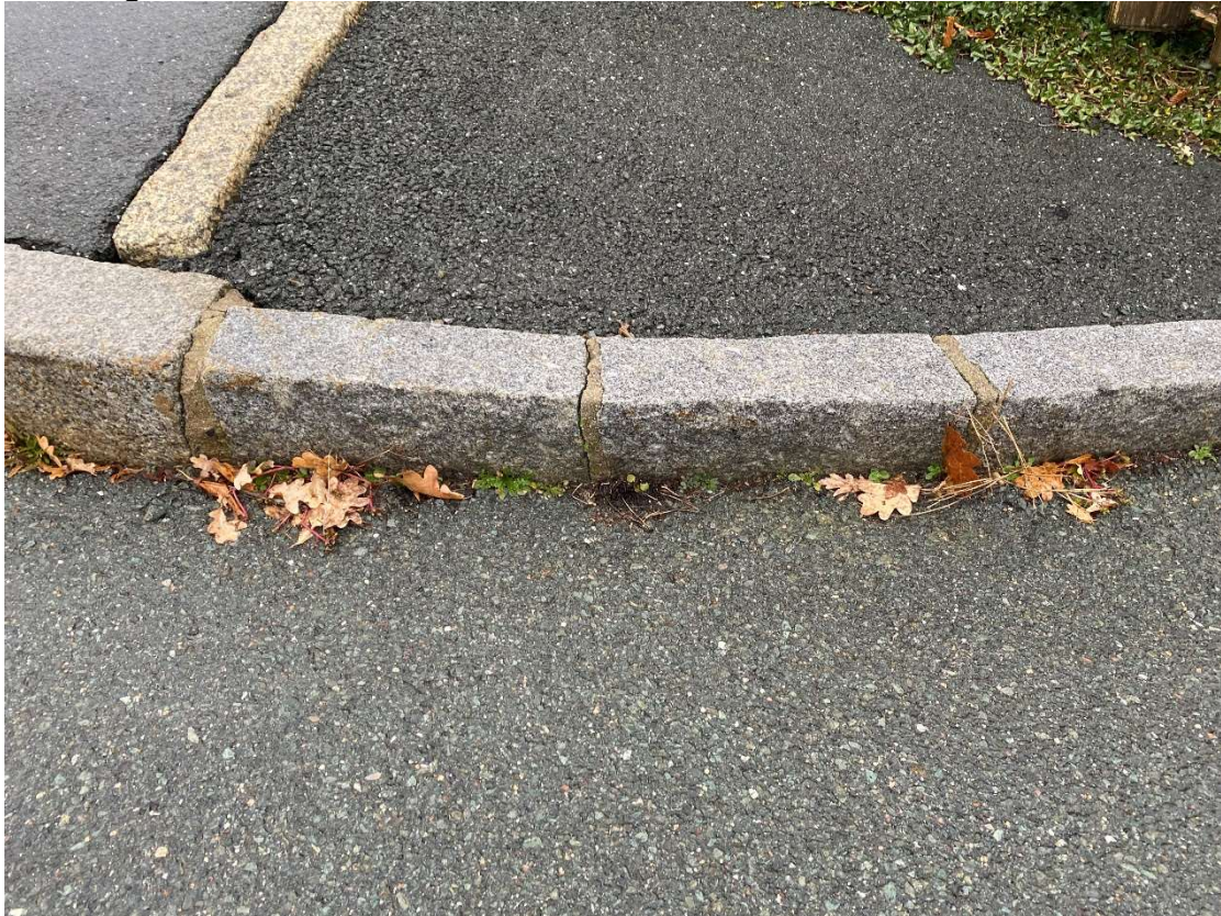
Bild 11: Aufreißender Fugenschluss unter Belastung
